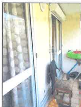
Photo N° 1844 AMIANTE CIMENT -Rdc-161-Séjour Mur extérieur Plaques planes (Fibres-ciment)
