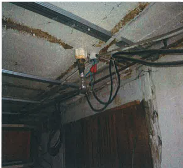
RDC : garage/matériels vétustes et non adaptés, conducteurs non protégés, boîte sans cache, canalisation sans fixation...
