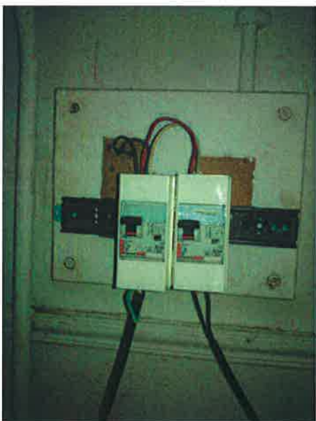
RDC : Chaufferie conducteurs non protégés.
