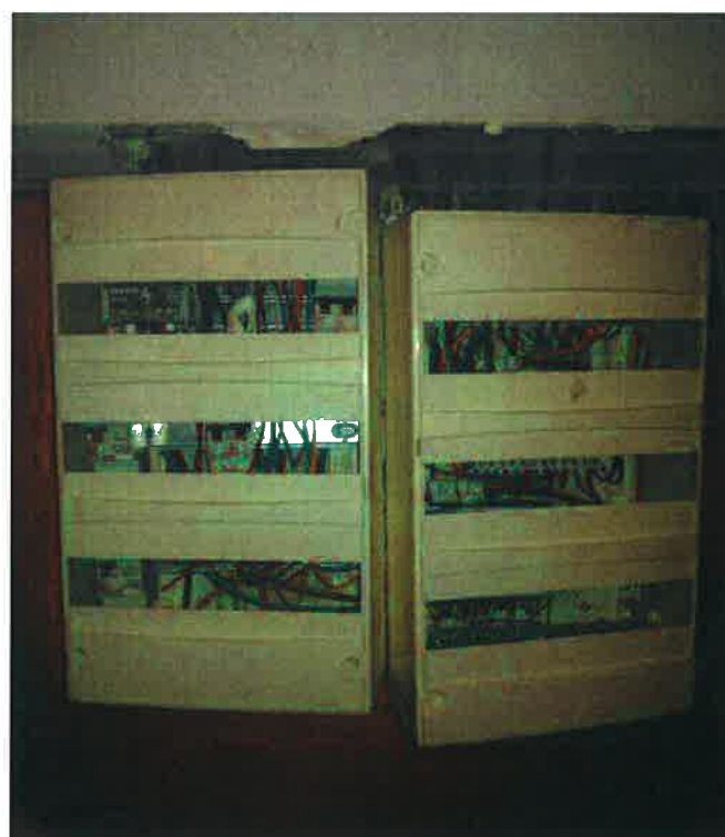
2 ème tableau dans le dégagement non accessible et non terminé.
