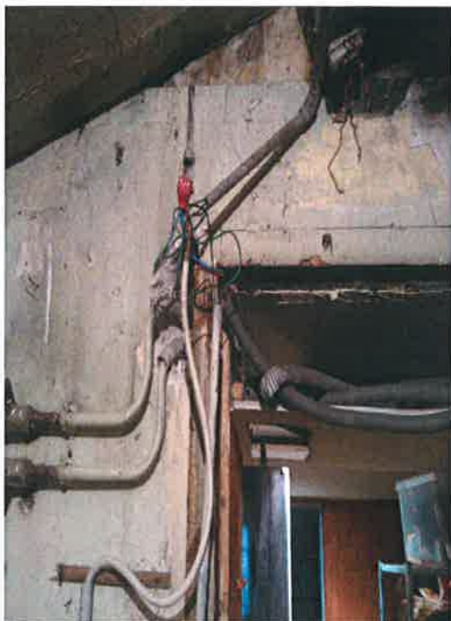
RDC : débarras/conducteurs non protégés
