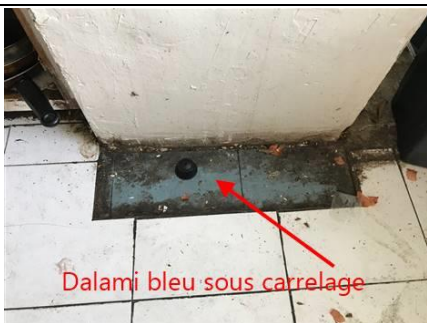
Photo n° PhA001 Localisation : Cuisine Ouvrage : 5 - Planchers et planchers techniques - Revêtements de sols Partie d'ouvrage : Dalle de sol Description : Dalles bleues type "dalami" Localisation sur croquis : 001
