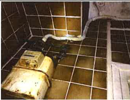
Photo n° du Compteur Gaz
