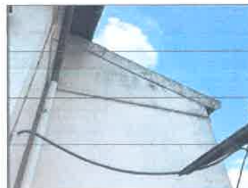
Photo N° 3123 AMIANTE CIMENT -Rdc-Salle de Bains Plafonds Rives (Fibres-ciment)
