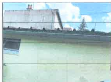
Photo N° 3122 AMIANTE CIMENT -Rdc-Chambre 4 Plafonds Toiture ondulée (Fibres-ciment)
