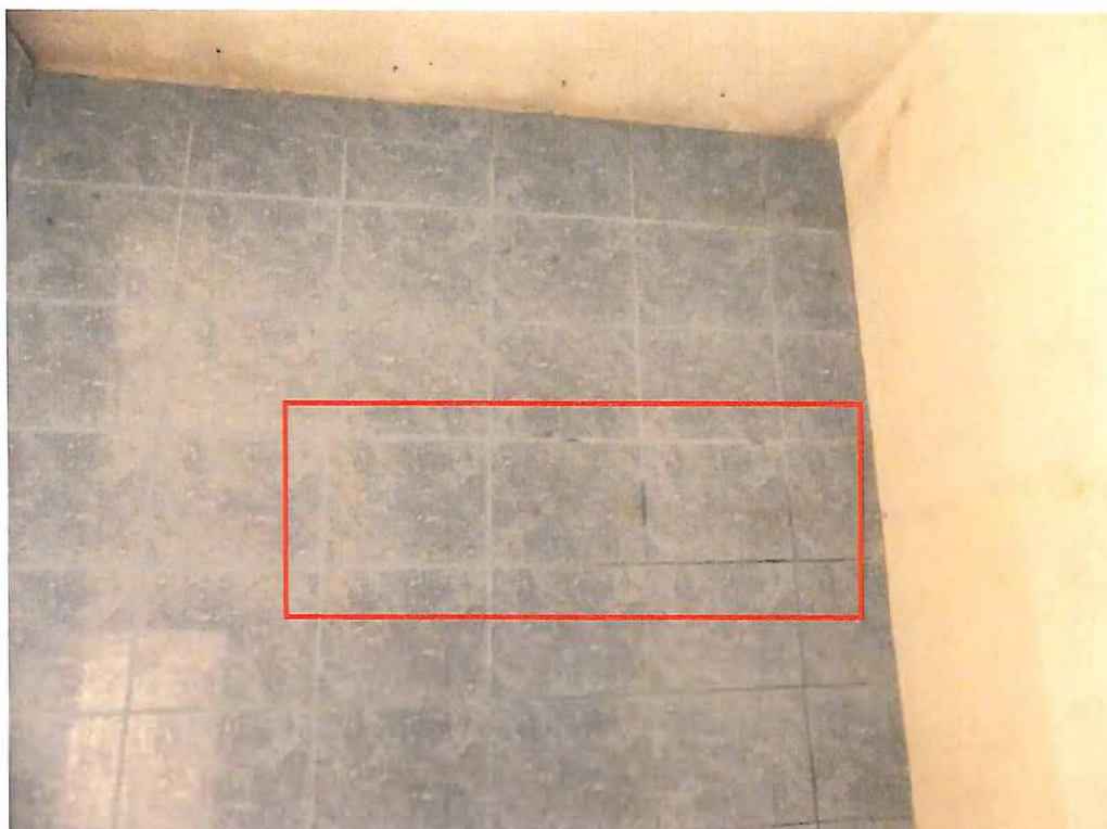
Crédence en faïence avec joints très usagés
