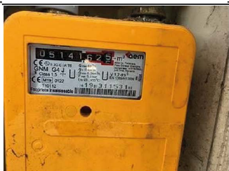
Photo n° du Compteur Gaz
