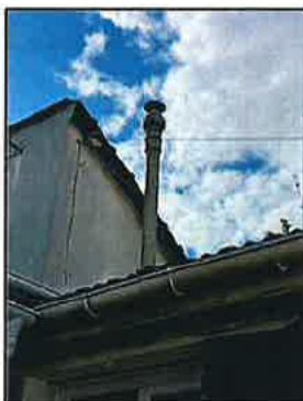
Photo N° 1 AMIANTE CIMENT -Rdc-Buanderie Conduits de fluide Ventilation haute + Chapeau (Fibres-ciment)
