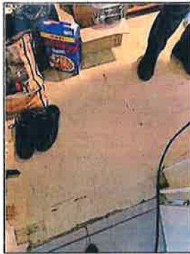
Photo N° 1 ECH-001 REVETEMENT DE SOL -Rdc- Chaufferie Planchers Dalles de sol 30x30 avec colle jaune
