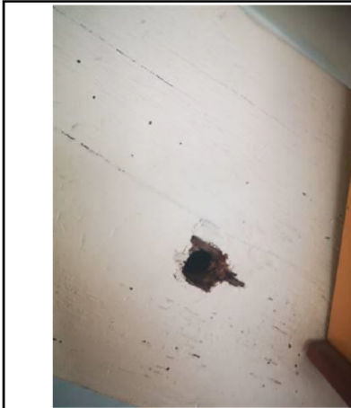
Photo n° PhTer001 Localisation : Combles aménagés - Pièce palière Ouvrage : Poutres apparentes Parasite : Anobium punctatum (Petites vrillettes) Indices : présence de trous de sortie (présence faible)
