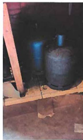
Stockage inadéquate de bouteilles de gaz domestique
