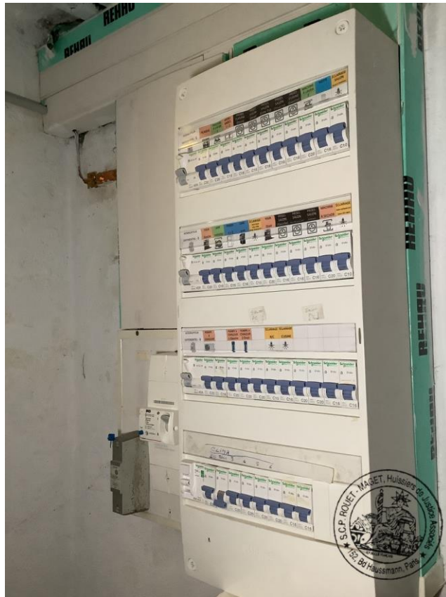
Compteur électrique en place
