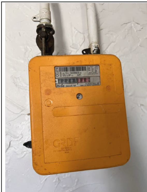
Photo n° du Compteur Gaz
