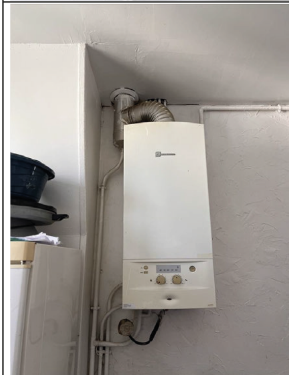
Photo n° PhGaz001 Localisation : Cuisine Chaudière e.l.m. leblanc (Type : Raccordé)
