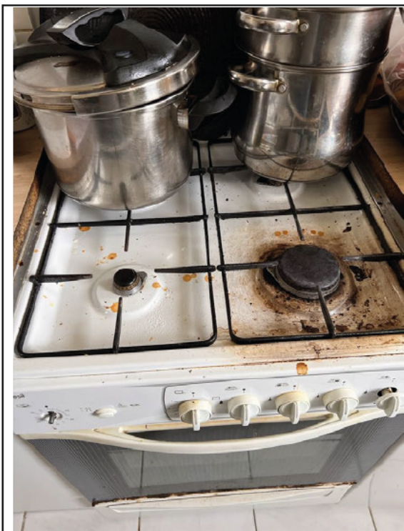
Photo n° PhGaz002 Localisation : Cuisine Cuisinière Indesit (Type : Non raccordé)
