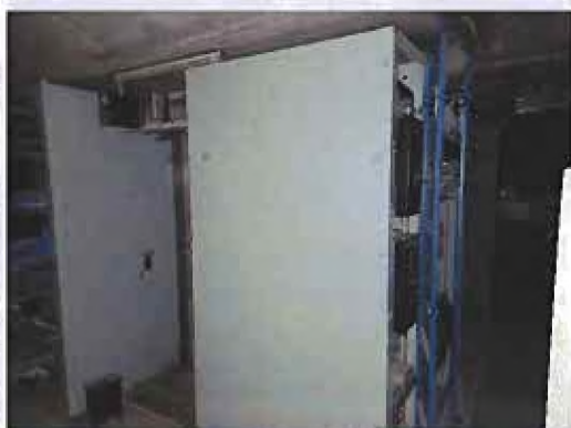
Poste transformateur fixe
