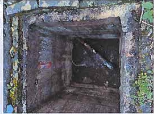
Regard de la cuve enterrée à proximité du bâtiment 2
