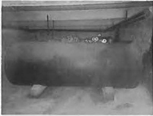
Cuves aériennes vraisemblablement vides
