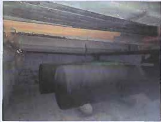
Cuves aériennes vraisemblablement vides
