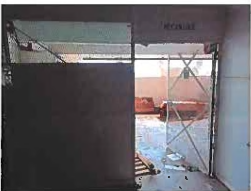
Ancien local transformateur
