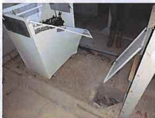
Poste transformateur sec
