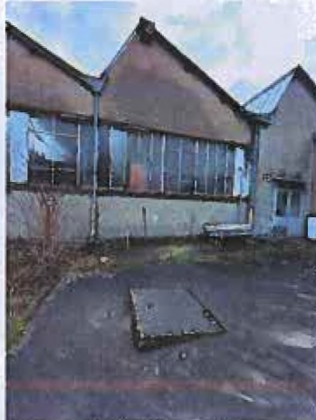
Tampon extérieur non ouvert
