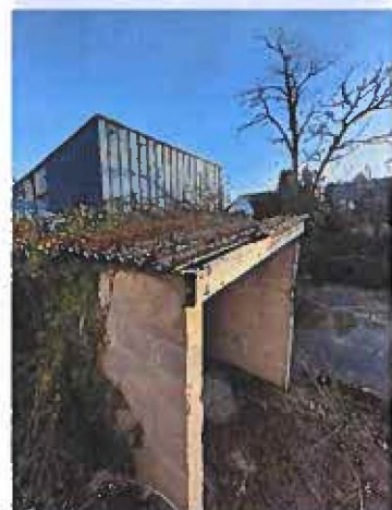
Abri à toiture dégradée Amiante suspectée
