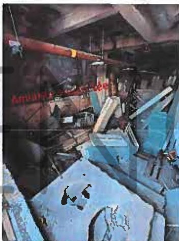
Amiante suspectée sur conduite
