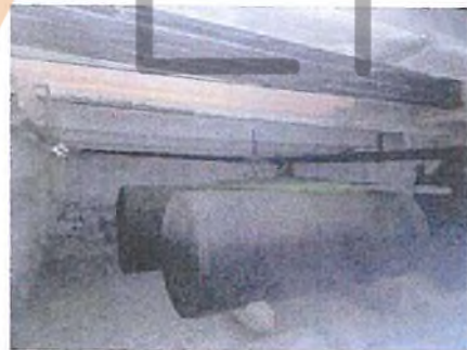
Local pompes : 2 cuves aériennes FDD vraisemblablement vides (faible hauteur sous plafond)
