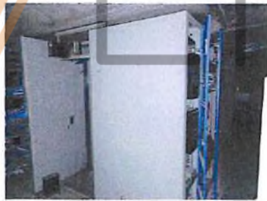
Poste transformateur fixe
