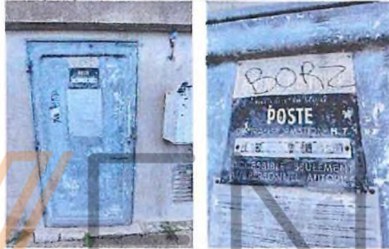
Poste transfo hors périmètre, en limite de parcelle sur boulevard de la Chesnardière (livraisons/expéditions)
