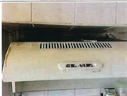
Photo n° PhGaz004 30 : Présence d'un appareil raccordé avec coupe tirage et sans ventilateur intégré et d'au moins d'un dispositif d'extraction mécanique supplémentaire. (Cuisine)
