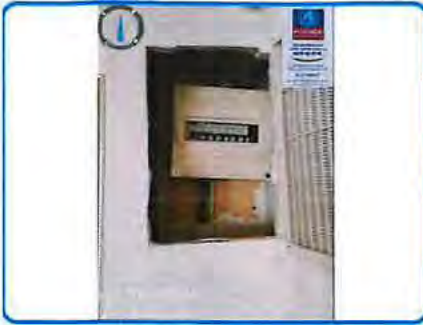
PROTEC.DIFF. sur Install. n°1 (dans 1er étage Entrée cuisine séjour) Anomalie B.7.3 a sur Install. n°1 App. n°1 (TRP n°1)
