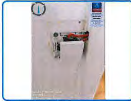
Anomalie B.7.3 a sur Install. n°1 Anomalie B.8.3 e sur Install. n°1
