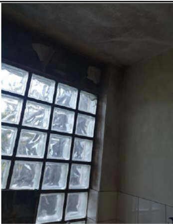
Photo n° PhTer001 Localisation : Nombreuses pièces au nord Ouvrage : Murs, plafonds, fenêtres ou pavés de verre Parasite : Moisissures noires Indices : présence étendue
