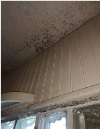
Photo n° PhTer001 Localisation : Nombreuses pièces au nord Ouvrage : Murs, plafonds, fenêtres ou pavés de verre Parasite : Moisissures noires Indices : présence étendue
