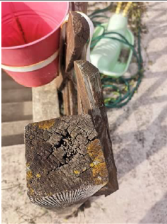
Photo n° PhTer001 Localisation : Maison - Extérieurs Ouvrage : Rambarde - Bois Parasite : Champignon de pourriture cubique du type lenzite des poutres (Gloeophyllum trabeum)(situé en extérieur) Indices : dégradation du bois (présence sur une partie de l'élément)
