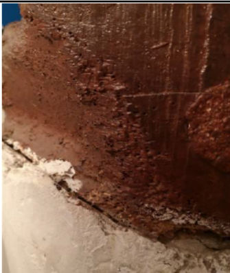
Photo n° PhTer001 Localisation : Rdc vers sous-sol - Escaliers Ouvrage : Poteau central - Bois Parasite : Anobium punctatum (Petites vrillettes) Indices : dégradation superficielle du bois (présence sur une partie de l'élément)
