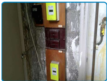
COMPTEUR sur Install. n°1 (dans Buanderie RDC surélevé Armoire électrique (partie commune))
