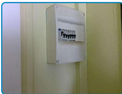
PROTEC.DIFF. sur Install. n°1 (dans Buanderie RDC surélevé Séjour Salon)
