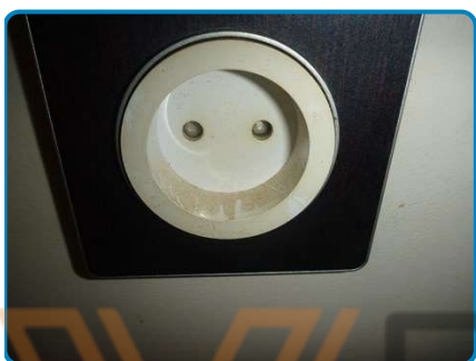
Anomalie B.3.3.6 a1 sur Install. n°1
