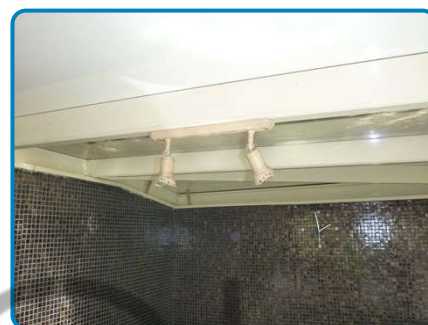
Anomalie B.6.3.1 a sur Install. n°1 App. n°3
