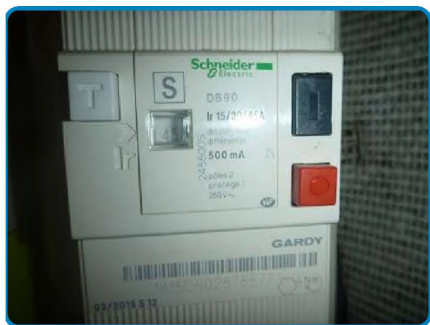
Anomalie B.8.3 e sur Install. n°1
