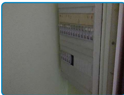
Anomalie B.7.3 a sur Install. n°1 App. n°1 (TRP n°1)
