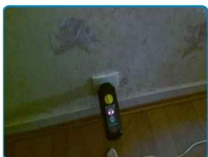
Anomalie B.3.3.6 a2 sur Install. n°1
