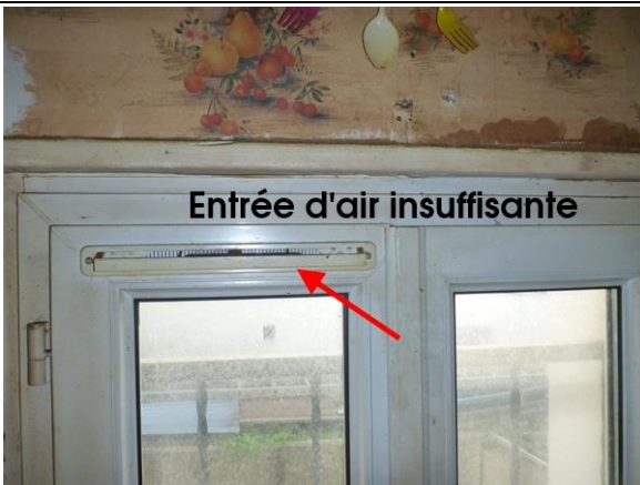
19.2 : la section de l'amenée d'air du local équipé ou prévu pour un appareil d'utilisation est manifestement insuffisante (Cuisine).
