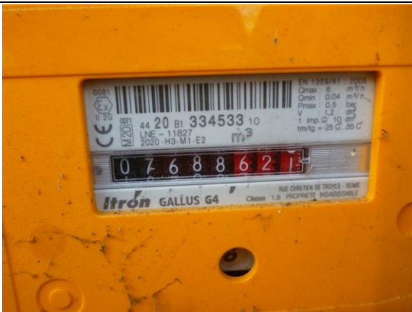
Compteur Gaz (mur de clôture)
