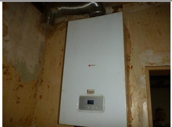
Localisation : Cuisine Chaudière SAUNIER DUVAL (Type : Raccordé)
