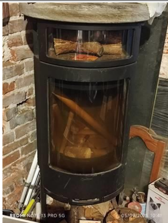
Photo PhDPE003 Ouvrage : Poêle
