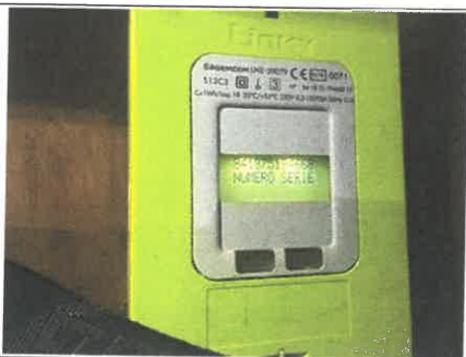
Photo du Compteur électrique
