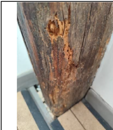
Photo n° PhTer001 Localisation : Séjour - Cuisine Ouvrage : Poutres - Bois Parasite : ---- Insectes à larves xylophages ---- Indices : dégradation superficielle du bois, présence de trous de sortie (présence sur une partie de l'élément)
