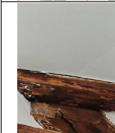
Photo n° PhTer002 Localisation : Chambre Ouvrage : Poutres - Bois Parasite : ---- Insectes à larves xylophages ---- Indices : dégradation superficielle du bois, présence de trous de sortie (présence faible)
