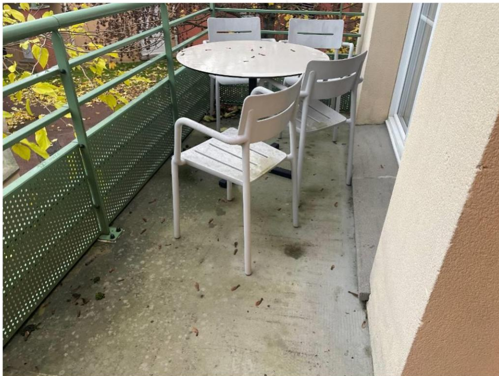
La rambarde est en état d'usage.
