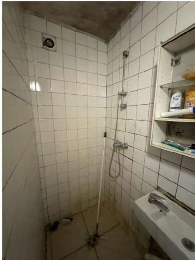
Un meuble-lavabo est apposé au pied du mur face, lequel est arraché du mur.
