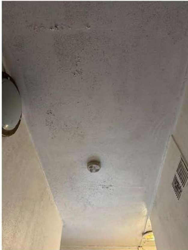
La peinture est en cours de décollage.
