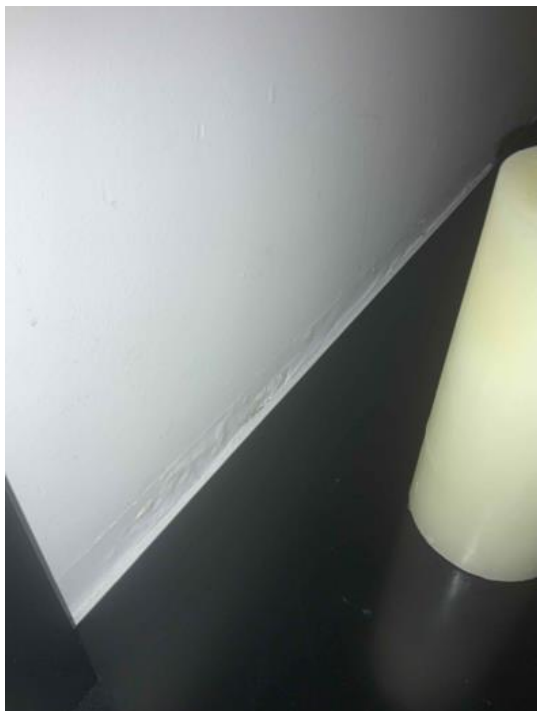
Mur mitoyen salle d'eau en pied de mur
