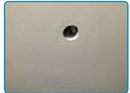
Anomalie B.8.3 e sur Install. n°1
