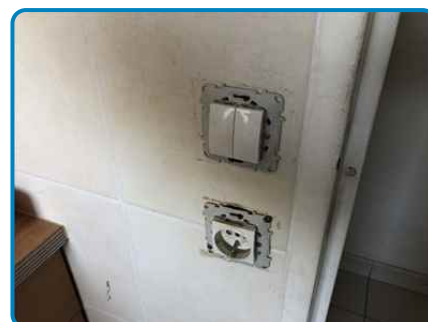
Anomalie B.7.3 a sur Install. n°1
