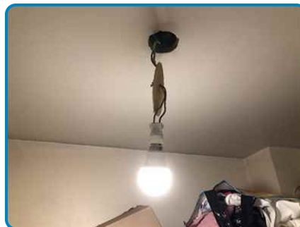
Anomalie B.8.3 e sur Install. n°1
