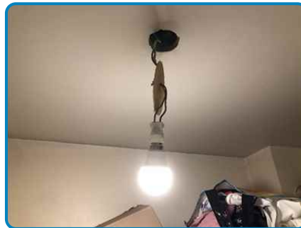
Anomalie B.8.3 b sur Install. n°1
