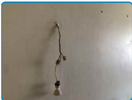
Anomalie B.8.3 e sur Install. n°1
