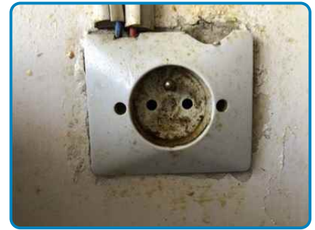
Install. n°1 : Au moins un socle de prise de courant n'est pas de type à obturateur.
