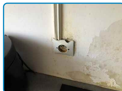
Anomalie B.7.3 a sur Install. n°1
