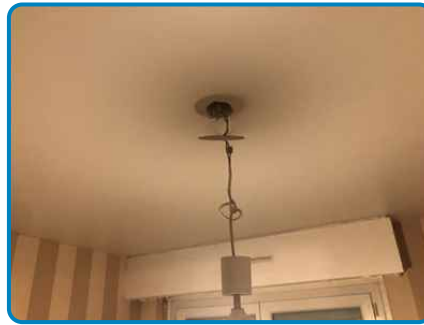
Anomalie B.7.3 d sur Install. n°1
