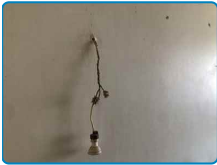
Anomalie B.7.3 d sur Install. n°1
