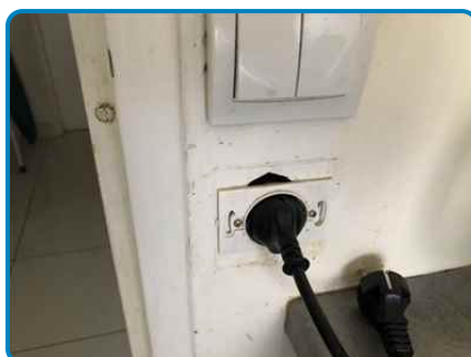
Anomalie B.7.3 a sur Install. n°1
