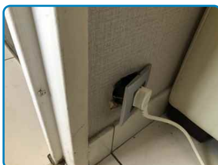
Anomalie B.7.3 a sur Install. n°1
