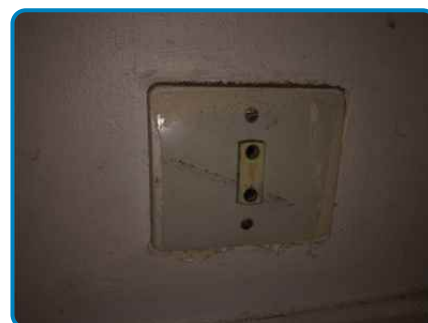
Anomalie B.3.3.6 a1 sur Install. n°1 Install. n°1 : Au moins un socle de prise de courant n'est pas de type à obturateur.
