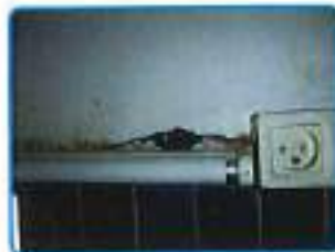
Anomalie 0.7.3 a sur install. n°1 Anomalie 0.7.3 d sur install. n°1 Anomalie 0.8.3 e sur install. n°1
