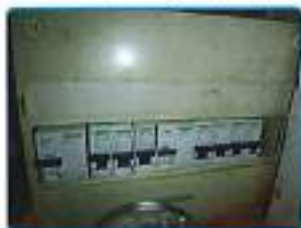
Anomalie 0.7.3 e sur install. n°1 App. n°1 (TRF n°1)
