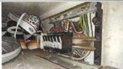
Photo du tableau électrique
